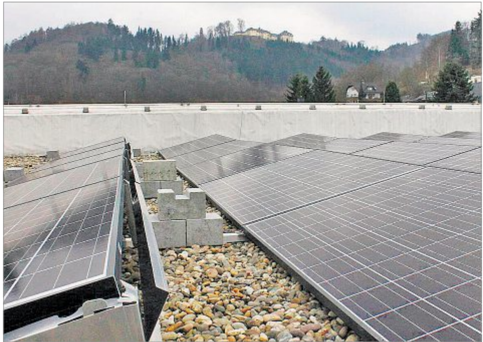
Auf dem Dach des Städtischen Gymnasiums Bad Laasphe produzieren 370 Module Strom – und das unter der Regie der neuen Energiegenossenschaft.
