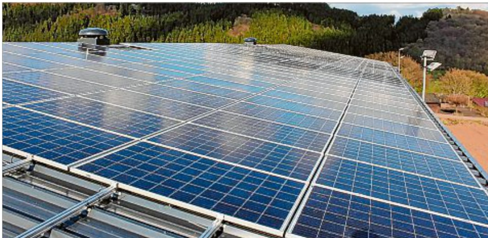
Die Module der Photovoltaik-Anlage sind auf der Kulturhalle in Dotzlar mittlerweile installiert. So steht die Inbetriebnahme kurz bevor.
